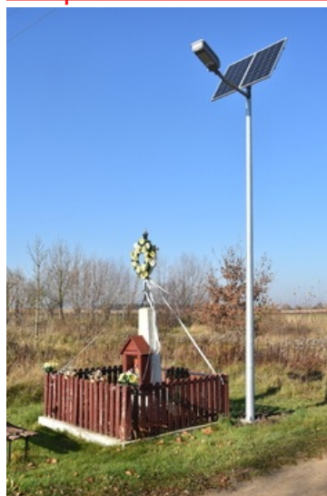
Lampa solarna w Koliszewie
